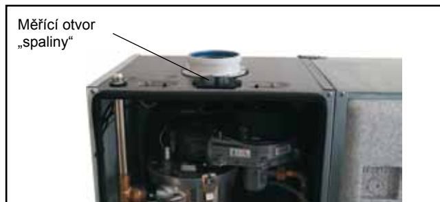
Obr. Měření spalin při otevřeném kotli
